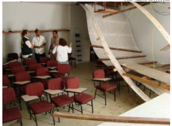
Sintuperj no local do desabamento
